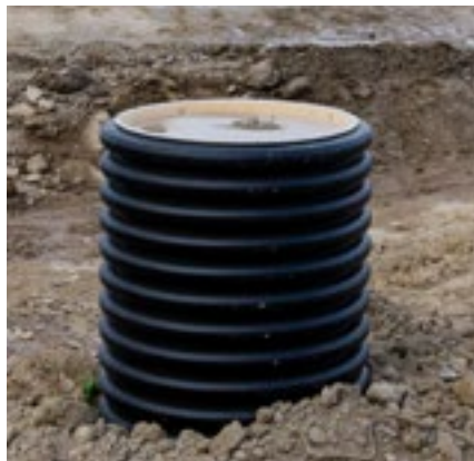
Rehausse de regard avec couvercle de chantier
