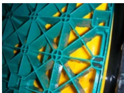
Gereinigde installatie zonder bezinsel, hier bij de stromingsscheider
