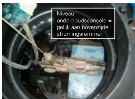
Controle van de reiniging d.m.v. een rioolinspectiecamera. De camera staat op de onderhoudsconsole van een SediPipe XL installatie.
